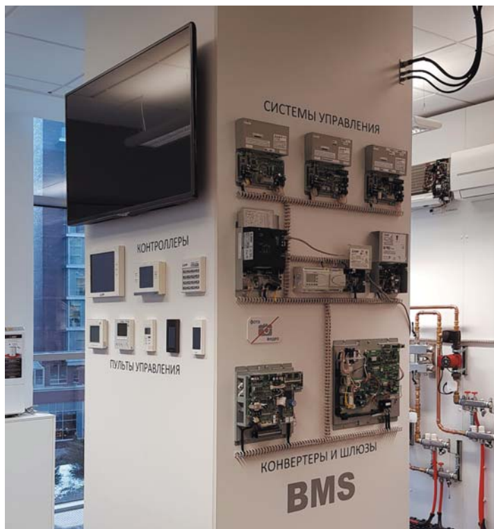
СИСТЕМЫ УПРАВЛЕНИЯ и ШЛЮЗЫ
